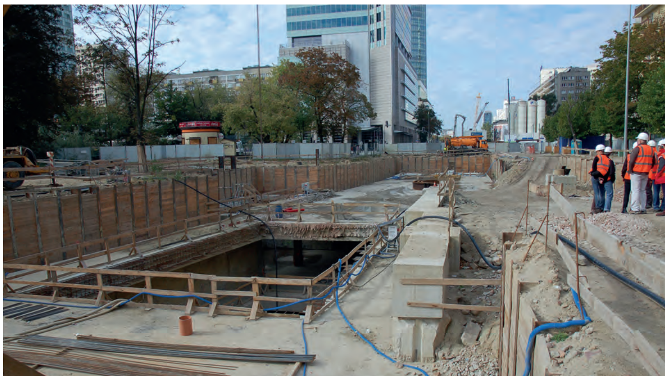
Badania geotechniczne podłoża II linii metra w Warszawie – stacja Świętokrzyska w czasie budowy
